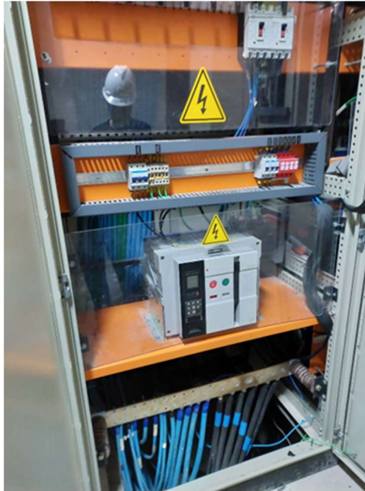
Foto: QGBT térreo Bloco A
