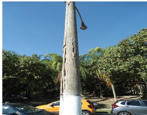
Foto 4 – Corrosão grave na armadura do poste
