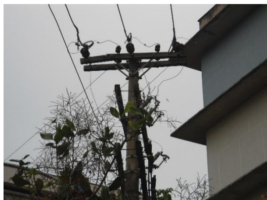
Foto 5 – Cruzeta de madeira deteriorada
