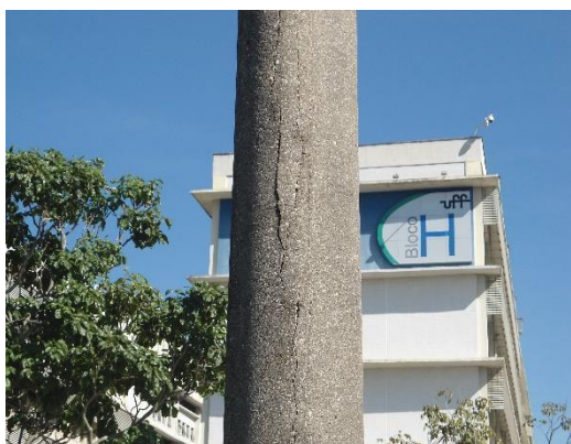
Foto 3 – Dano na capa externa de concreto
